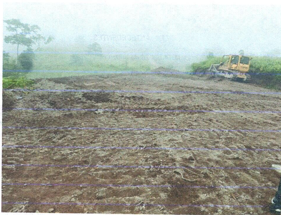
Imagen 2: evidencia fotográfica suministrada del año 2025
